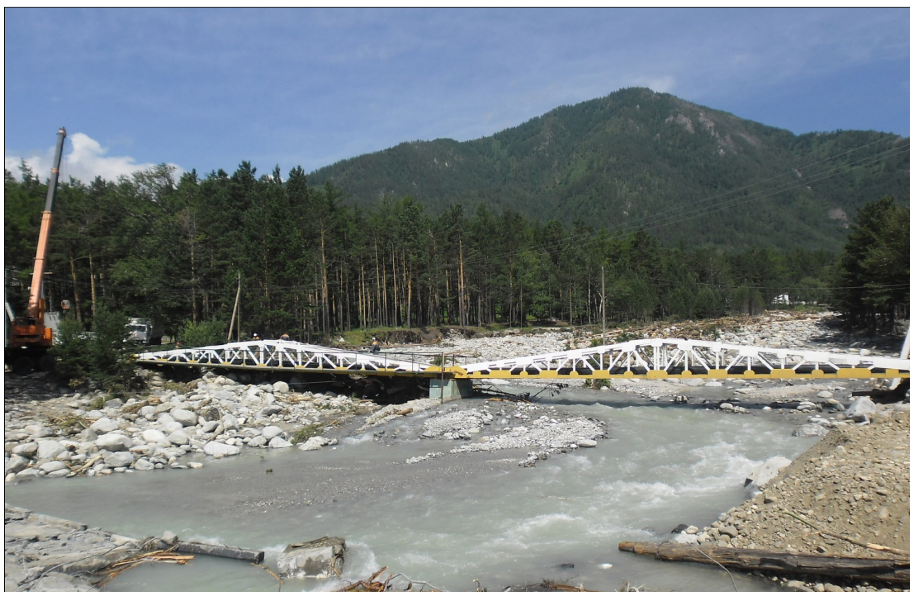
Фото 8-1. Фото 8-2. Паводок на р. Кынгарге повредил мосты.
